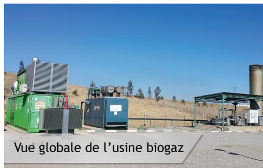
Figure 53 : Vue générale de l'usine de biogaz
